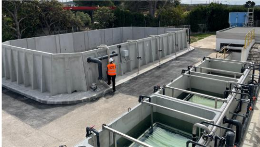
Membranas de ultrafiltración MBR
