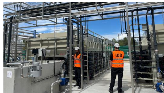
Tanques de reciclado
