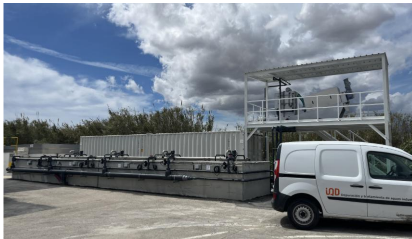
Unidad de regeneración de aguas compacta en contenedor
