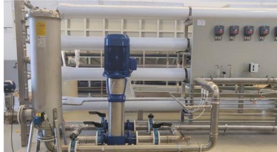
Ósmosis inversa para aguas residuales
