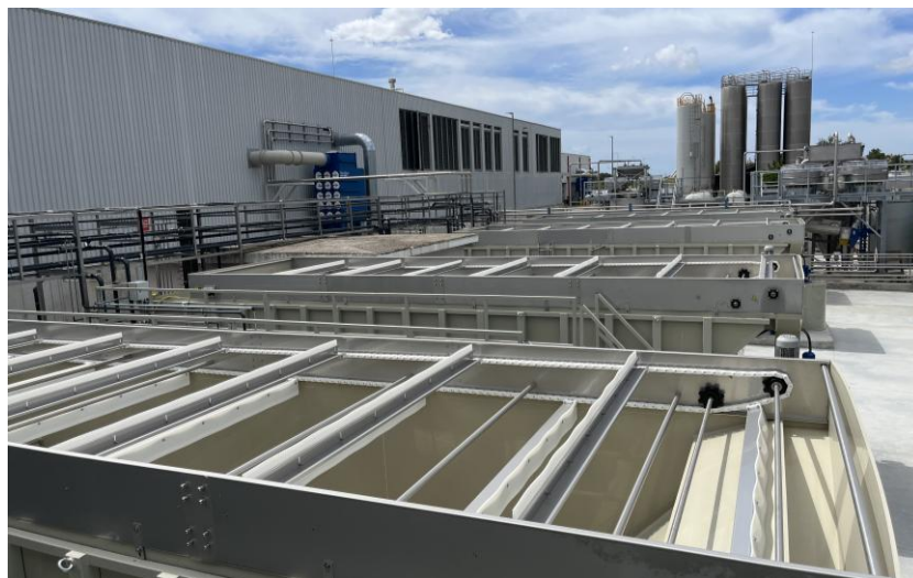
Planta depuradora de reciclado de plásticos
