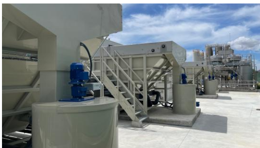
Flotadores CAF por línea
